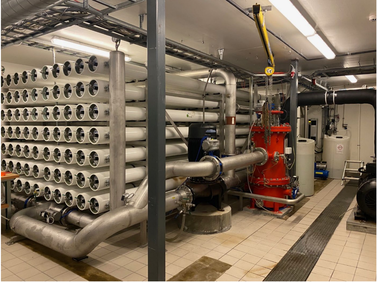
Membranlegget montert i 2016, utvida kapasitet og nye membranar desember 2020
